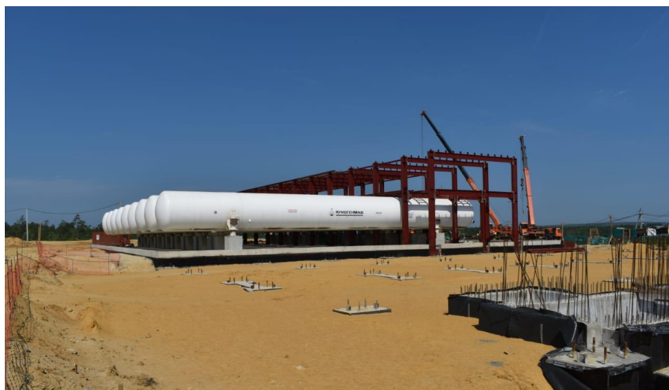
Рис. 2. Расположение криогенных резервуаров РЦГ-250/0,6, РЦГ-250/1,0, РЦГ-250/1,1 на космодроме "Восточный".
