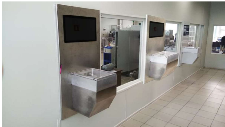
Рис. 7. Фотография установок, размещенных в «чистой» комнате.
